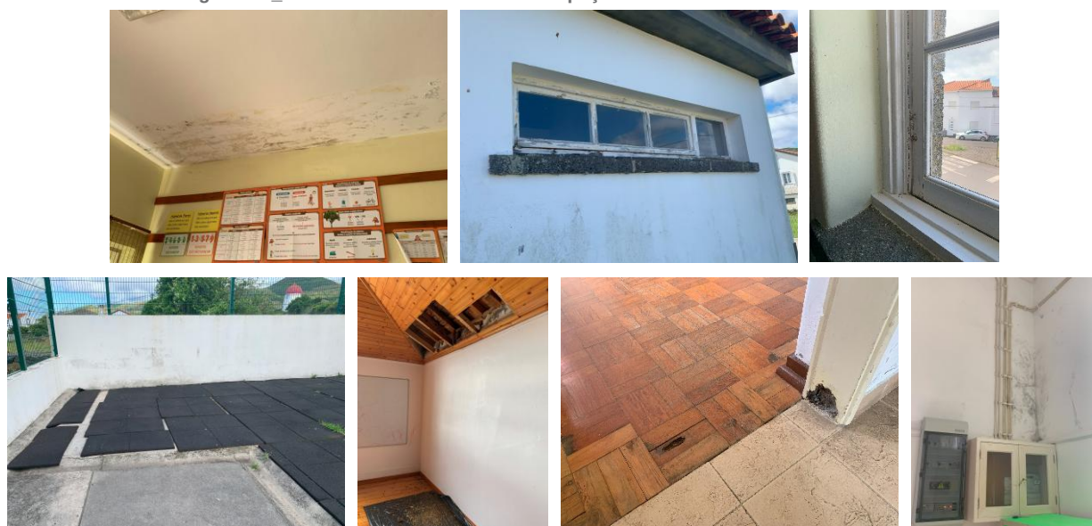
Figura 3.9_Problemas identificados nos espaços interiores e exteriores das EB1/JI
